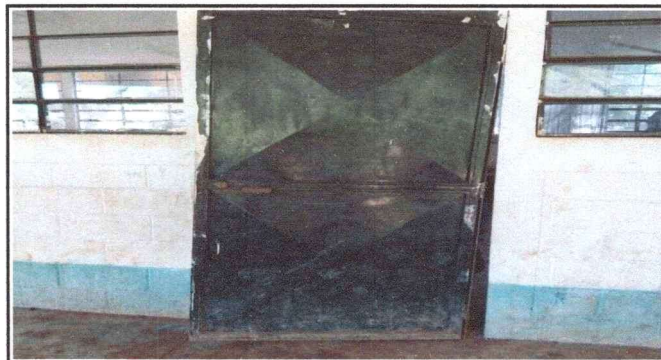
Foto 4: "Solicito el cambio de la chapa de la puerta. Es necesario instalar una nueva chapa para asegurar el buen funcionamiento y la seguridad."
