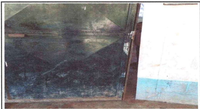
Foto 3: "Solicito la reparación de la puerta No. 2 que se ha desprendido de la base en la pared. Es necesario realizar un trabajo de soldadura para fijarla correctamente."
