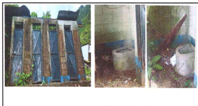
Foto 6: cambio de techo, reparacion de repello y cernido de paredes en 3 sanitarios y sustitucion de inodoro
